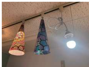
AC 100V電源(天吊り型)
